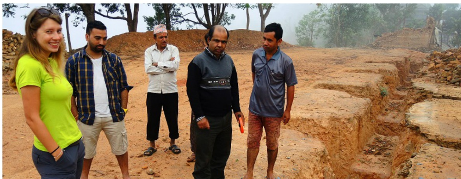
Pozwolenie na budowę szkoły oraz pierwsze prace budowlane (11.2015-06.2016 r.), fot. Maciej Pastwa.
