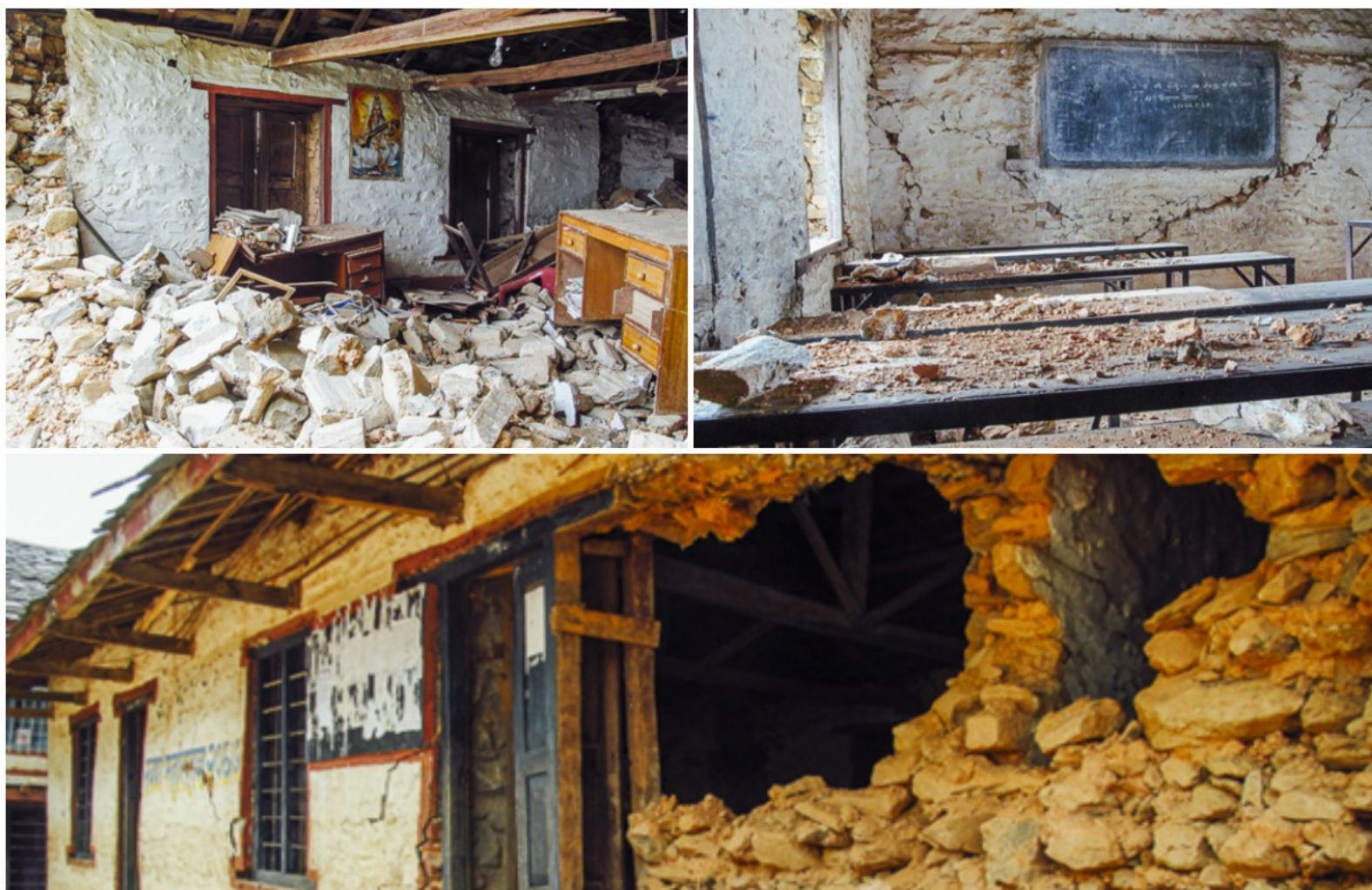
Zniszczona szkoła w Bakrang-6, Nepal (05.2015 r.), fot. Maciej Pastwa.
